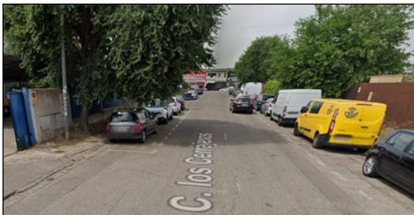
Ilustración 11. Calle Los Cerrajes Vegetación en la acera y mal estado.
